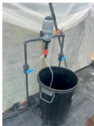
Sistema sencillo de inyección de abono (bomba hidráulica).
